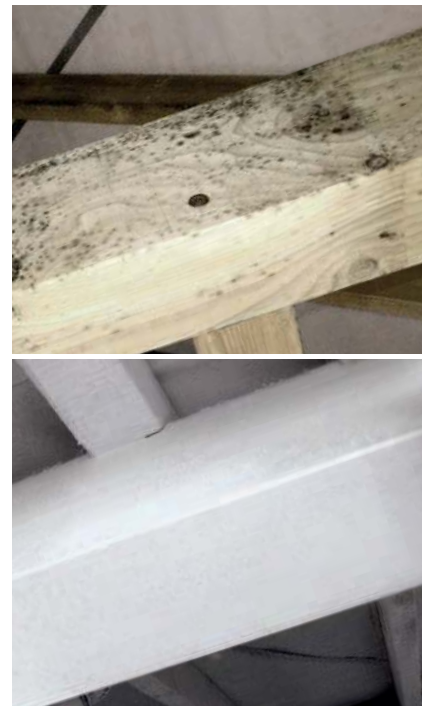
KALK BEKÄMPFT SCHIMMELPILZE IM NEUBAU Nachdem der Estrich und der Putz verarbeitet worden waren, kam es zu einem heftigem Schimmelpilzbefall. Nach fachgerechter Beseitigung der Schimmelflecken, wurde das gesamte Tragwerk mit Kalk beschichtet.
